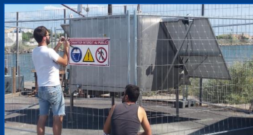
Installation du lidar côtier au Barcarès
